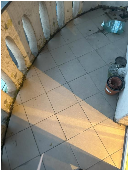
płytki na balkonie m.7
