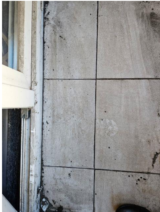
płytki na balkonie m.3
