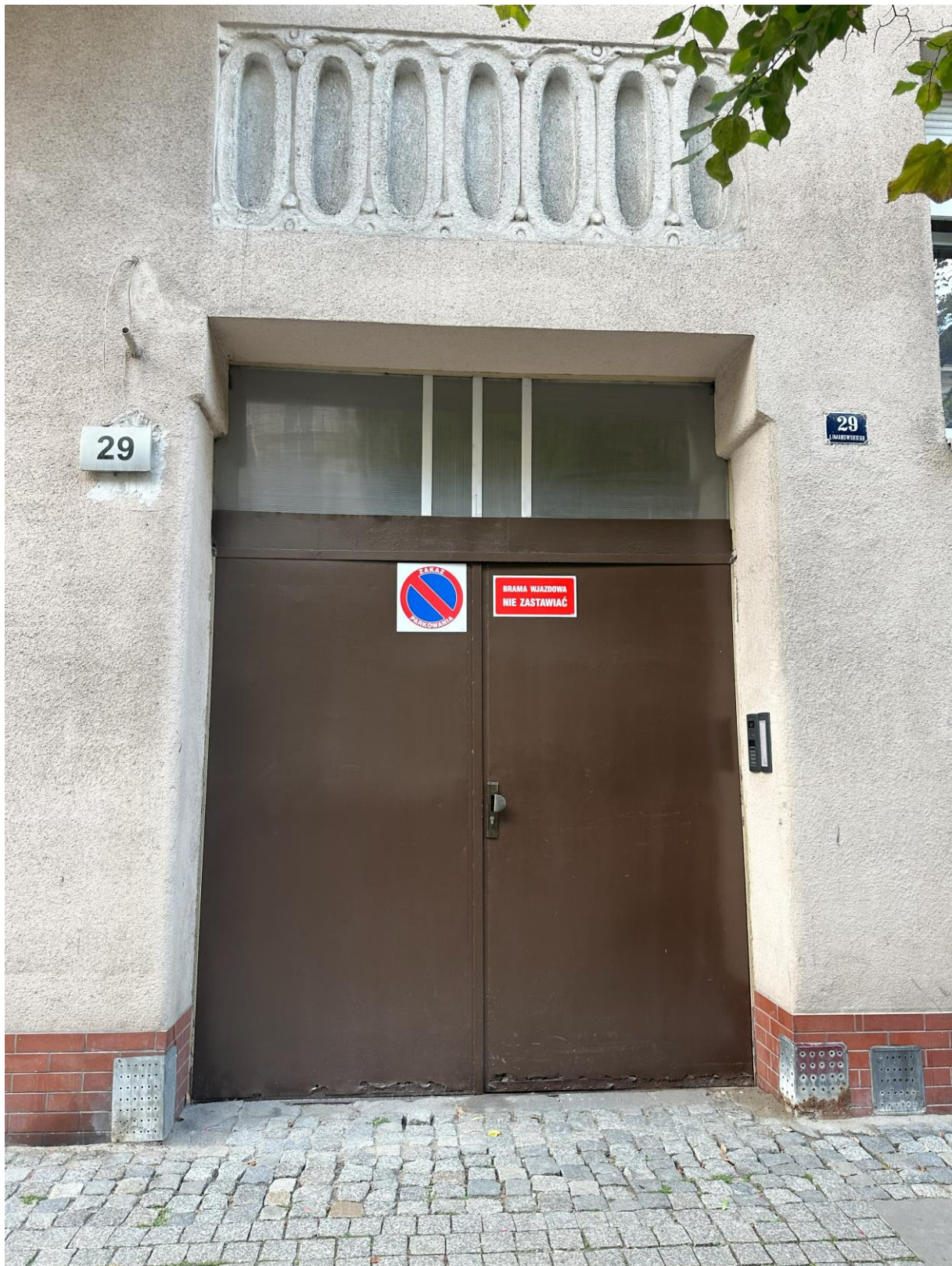
Wtórna brama stalowa przeznaczona do wymiany
