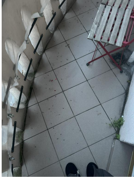
płytki na balkonie m.8
