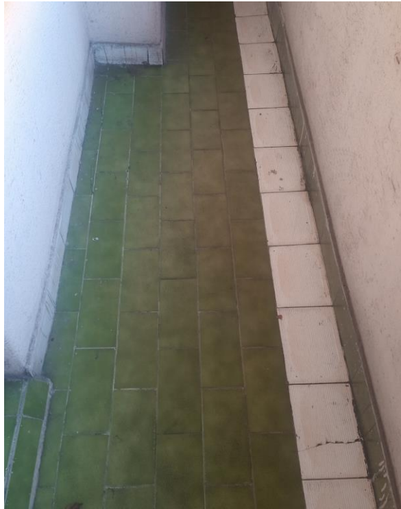
płytki na balkonie m.13
