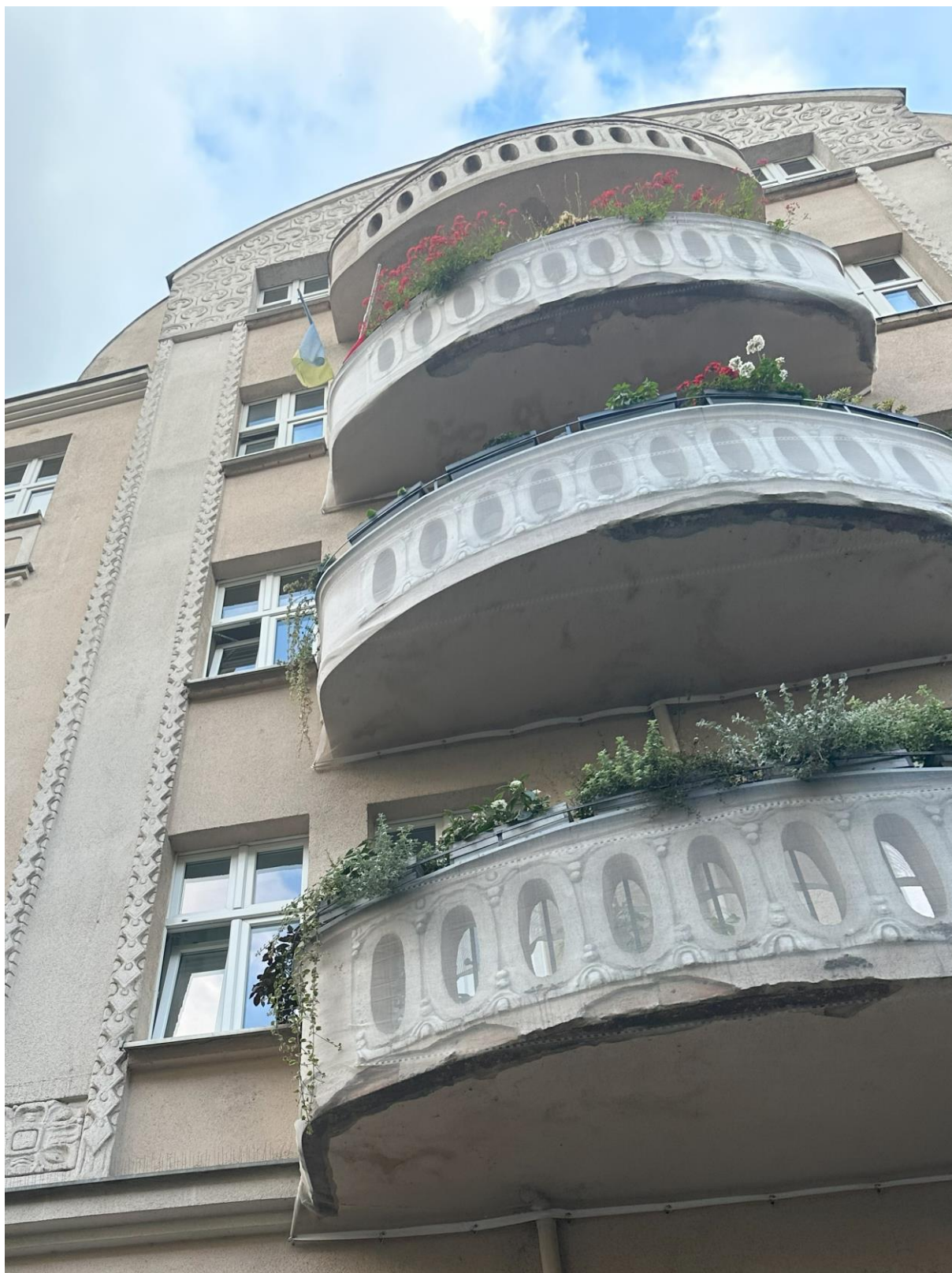
Uszkodzone odspojone tynki od spodu balkonów
